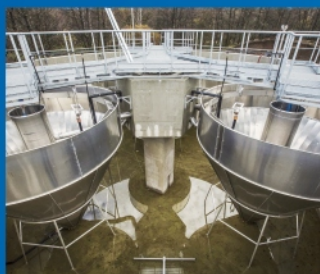
Vložené dosazovací nádrže
